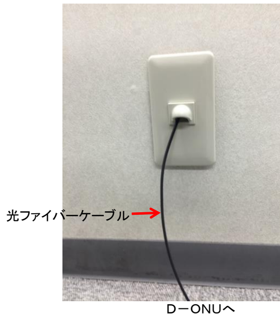
④配管出口(宅内) 光インターネット・光電話
