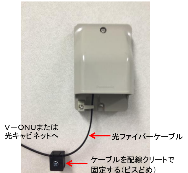
②配管入口(外壁面) 光インターネット・光電話
